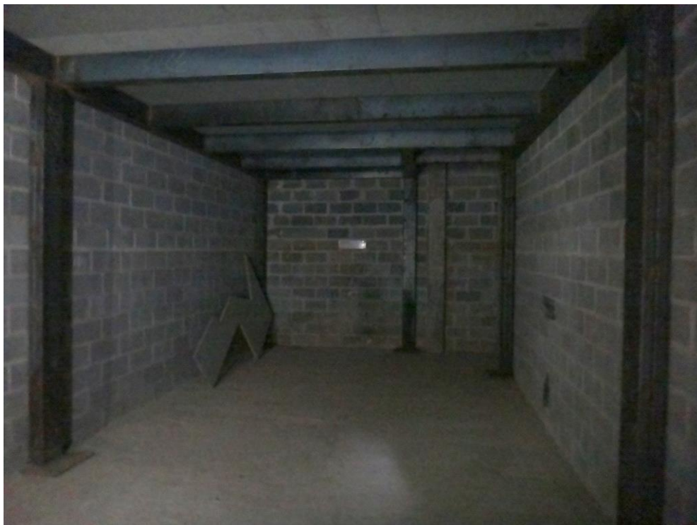
Foto 4 – Interior (fundos) do espaço da loja 20
