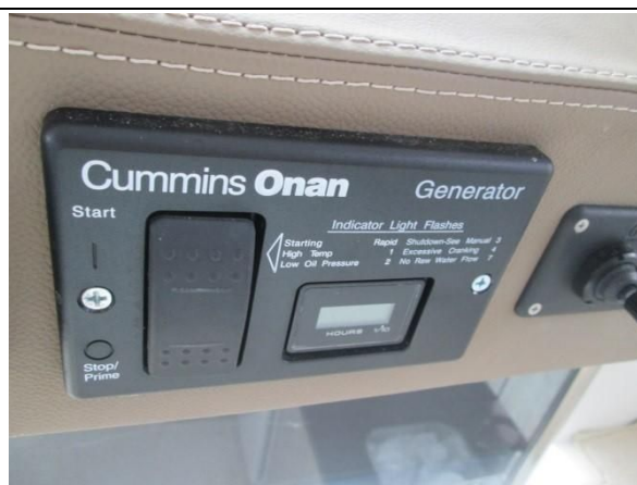
38. Controle do Gerador
