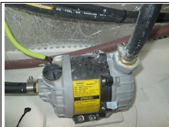
51. Compressor do ar condicionado
