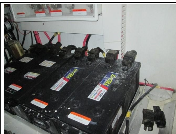
52. Sistema de baterias
