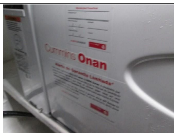
50. Identificação do Gerador
